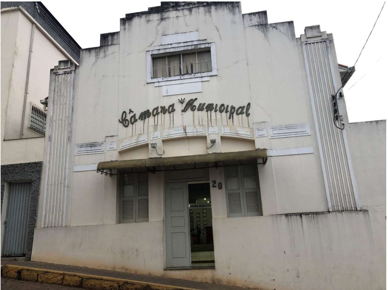
Fachada necessitando de reparos na pintura e estetica
