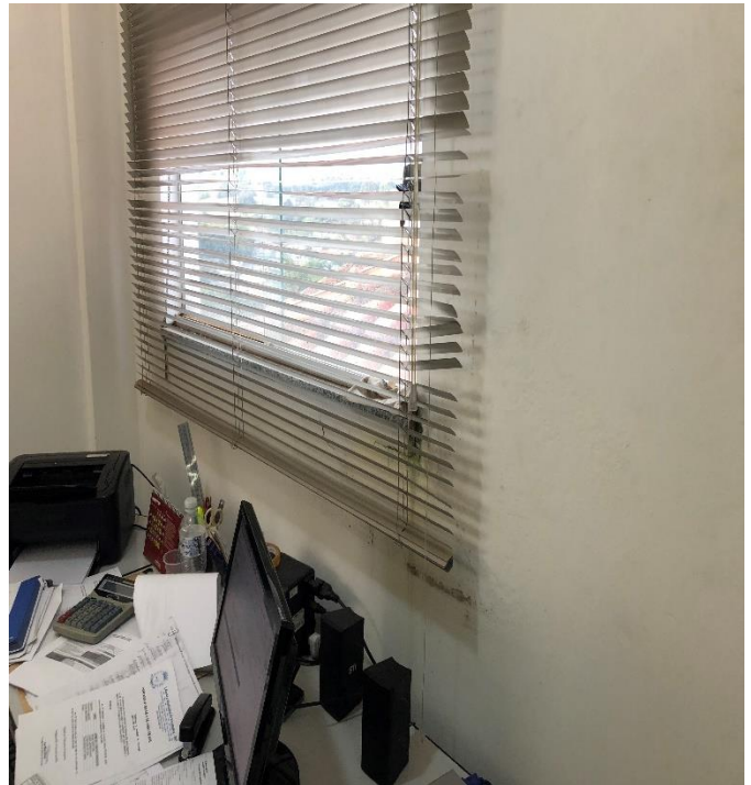
Infiltração abaixo da soleira da janela
