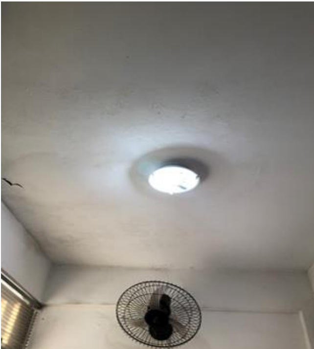
Teto com infiltração vinda do telhado
