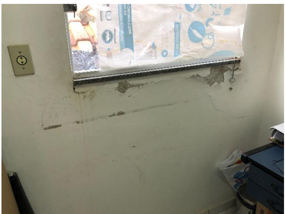
Infiltração na soleira da janela
