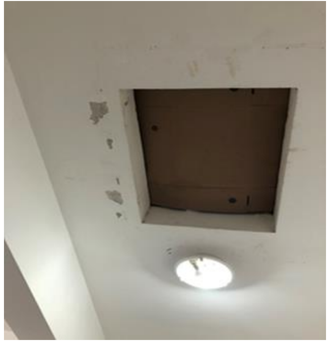
Alçapão necessitando de porta
