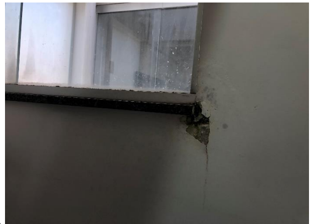
Infiltração na soleira da janela
