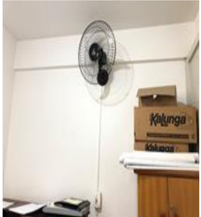
Paredes necessitam de nova pintura
