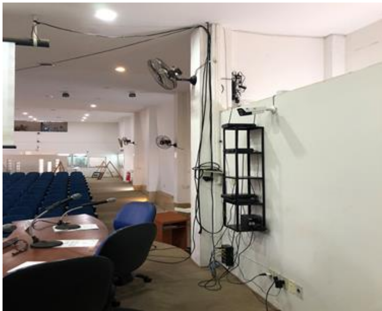
Parte elétrica que necessita organização dos cabos
