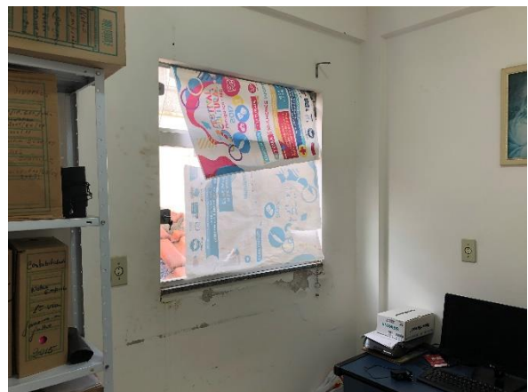
Necessidade de perciana na janela
