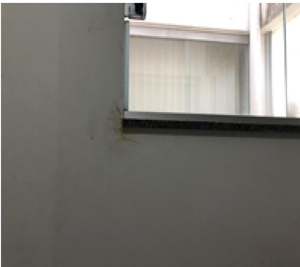
Infiltração abaixo da soleira da janela
